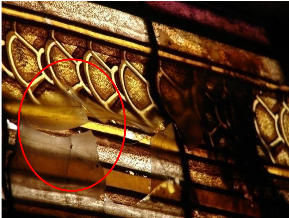
Figura 47: destacamento da pintura
